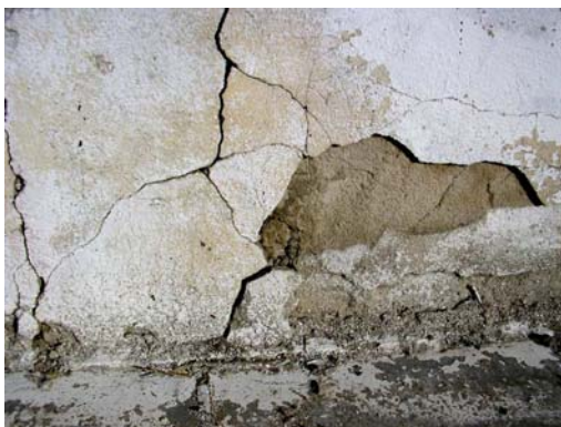
Рис. 1. Общий вид трещины
