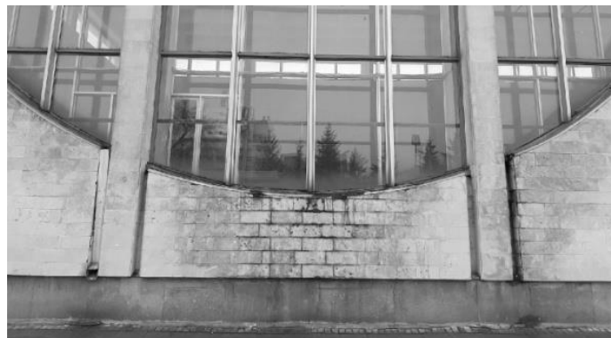
Рис. 9. Коррозия каменной кладки фасада
