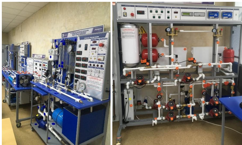
Рисунок 1. Лабораторные стенды по системам водоснабжения и отопления
