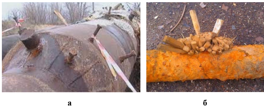
Рисунок 2. Ветхие трубопроводы, подвергнутые ремонту с использованием сварных болтов (а) и деревянных кольев (б)
