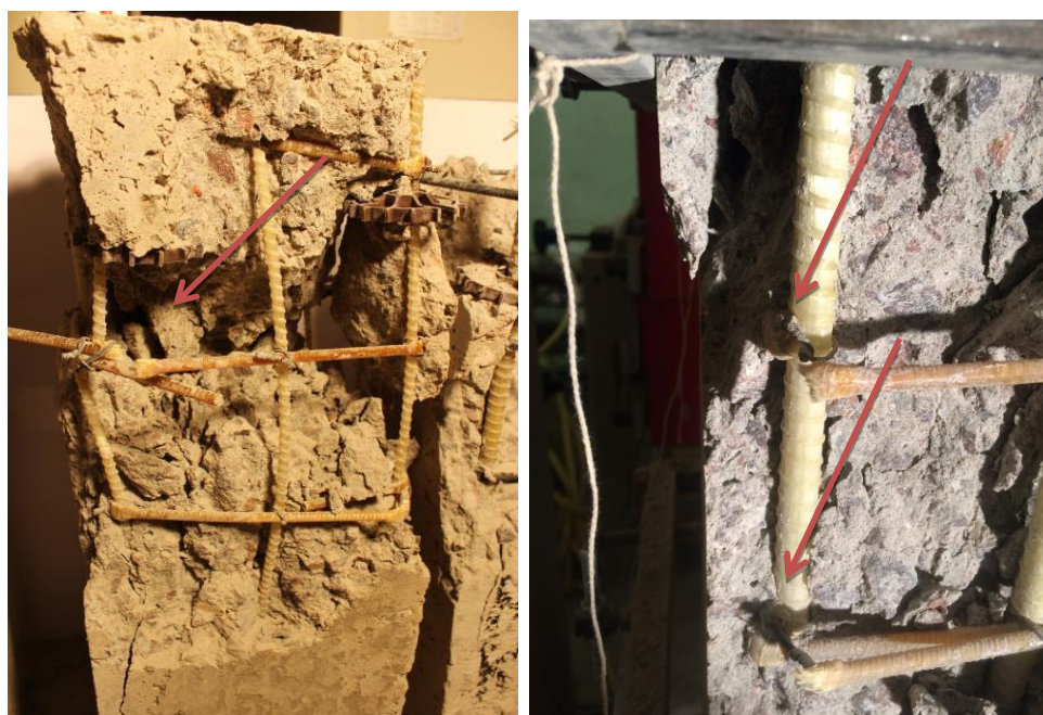
Рисунок 4 – Разрыв поперечной стеклокомпозитной арматуры (хомутов)
